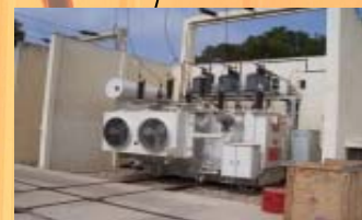
Transformateur (à chaque fois que tu vois une boîte avec un T rouge) ou poste de transformation
