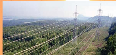
Lignes haute tension et pylônes
