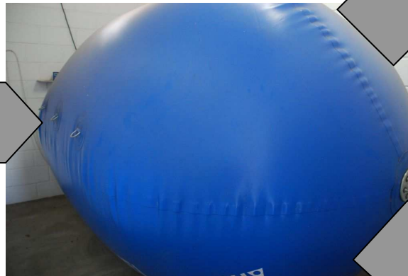
Stockage intermédiaire du biogaz
